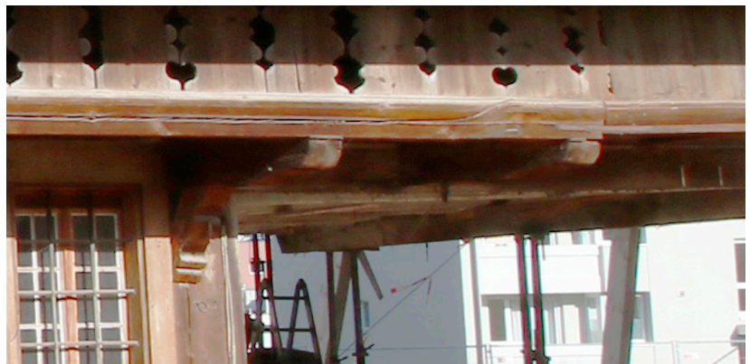
Schrift an Balkenabschnitt zwischen den zwei Laubenpfetten, Ostseite
